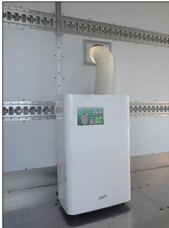
7. スポットクーラー設置状況
